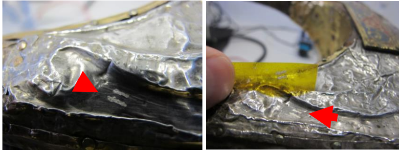
Fig. 175 : Arrachement local de l'argent réduit par le scotch de fixation du ruban d'aluminium utilisé pour la mise en contact électrique des plaques métalliques.
